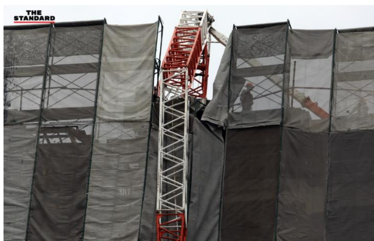
รูปที่ 6 อุบัติเหตุปั้นจั่นถล่ม มีแผ่นเหล็กนั่งร้านร่วงใส่หลังคาลานอเนกประสงค์ โรงเรียนอัสสัมชัญ คอนแวนต์
