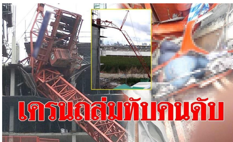
รูปที่ 4 อุบัติเหตุปั้นจั่นถล่มในพื้นที่ก่อสร้างคอนโดมิเนียม The Rise Rama9 ถนนพระราม 9 (ข่าวสด, 2561)
