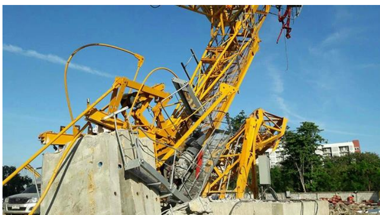
รูปที่ 3 อุบัติเหตุปั้นจั่นถล่มภายในพื้นที่ก่อสร้างโรงเรียนนานาชาติ พระราม 9 กรุงเทพมหานคร (MGR Online, 2016)
