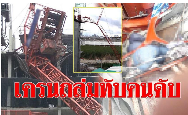
รูปที่ 4 อุบัติเหตุปั้นจั่นถล่มในพื้นที่ก่อสร้างคอนโดมิเนียม The Rise Rama9 ถนนพระราม 9 (ข่าวสด, 2561)
