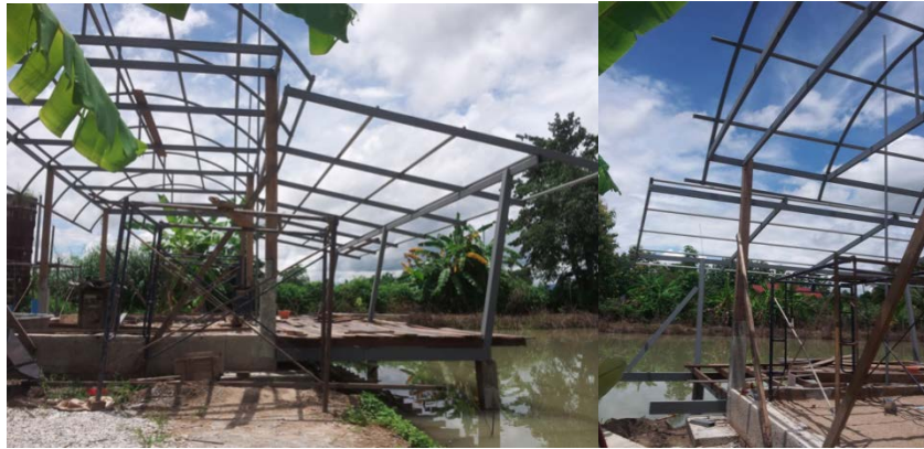
รูปที่ 4 เตรียมโครงสร้างอาคารและ โครงสร้างหลังคา
