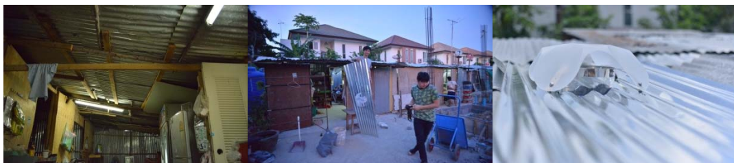
รูปที่ 10 ติดตั้งผลิตภัณฑ์ให้แสงและระบายอากาศกับบ้านในชุมชนแออัด
